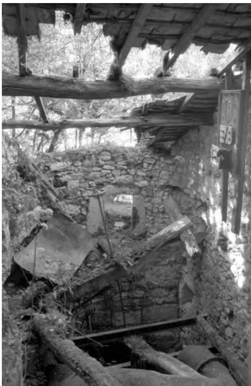
Site de la cascade : intérieur du bâtiment d'eau.
