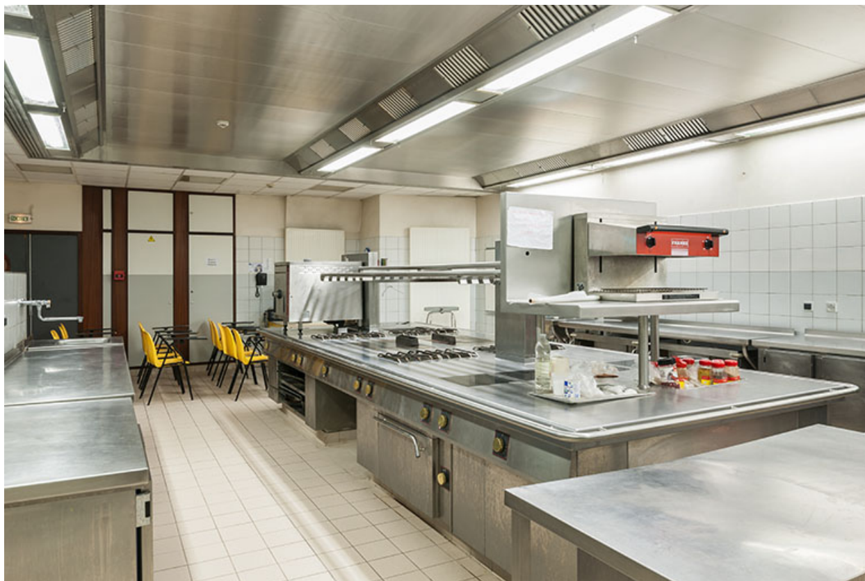
Cuisine du restaurant d'application.
