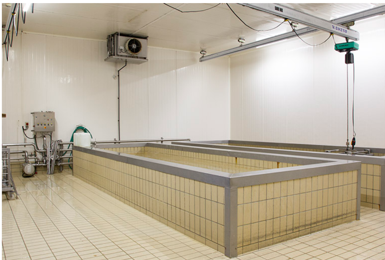
Atelier de saumurage : vue d'ensemble.
