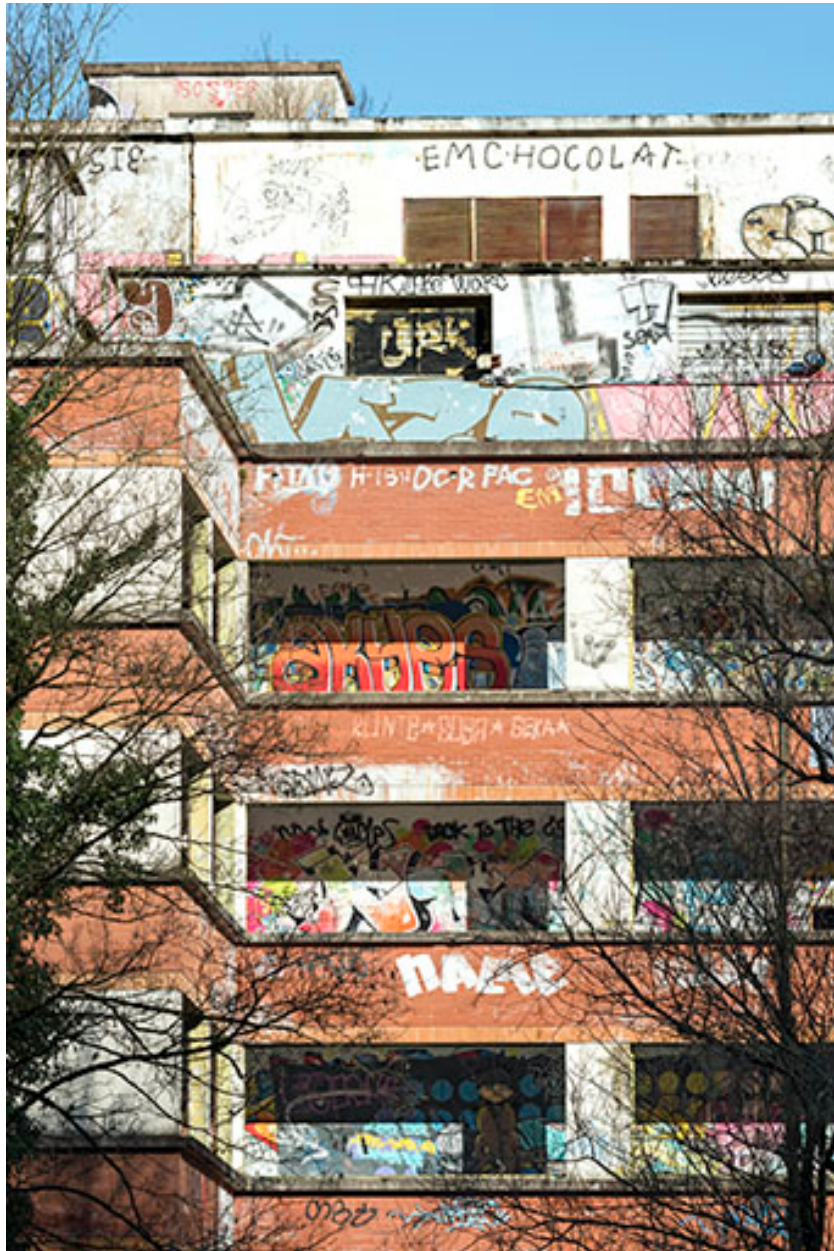
Etat en 2016. Usine A : tags sur l'atelier d'étirage tergal et nylon.
