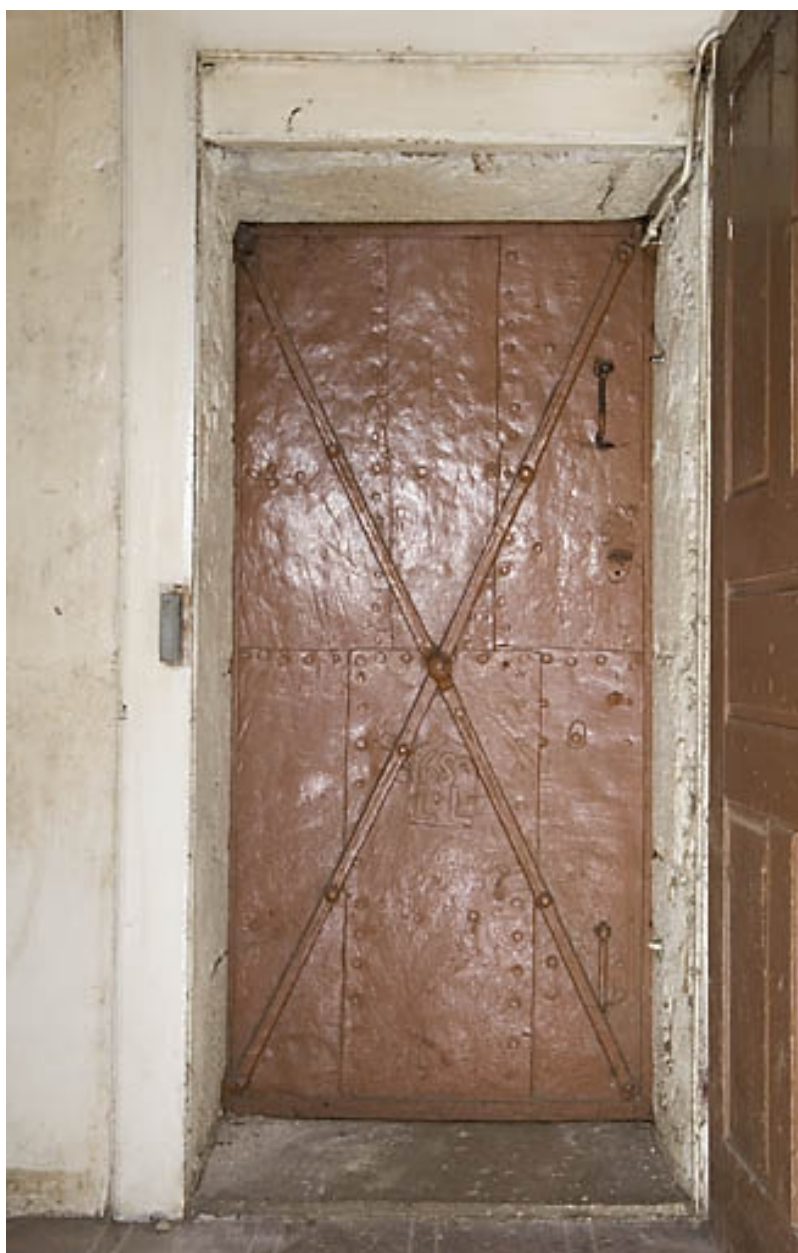
Ferme au 17 rue du Faubourg : porte coupe-feu métallique.
