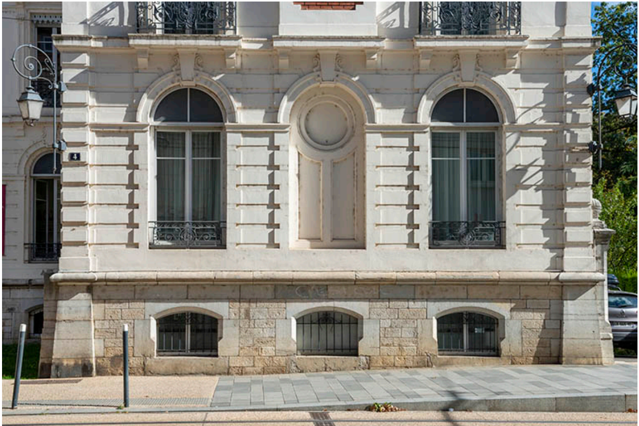
Façade sur l'avenue Carnot, avant-corps de droite, détail de l'étage de soubassement.
