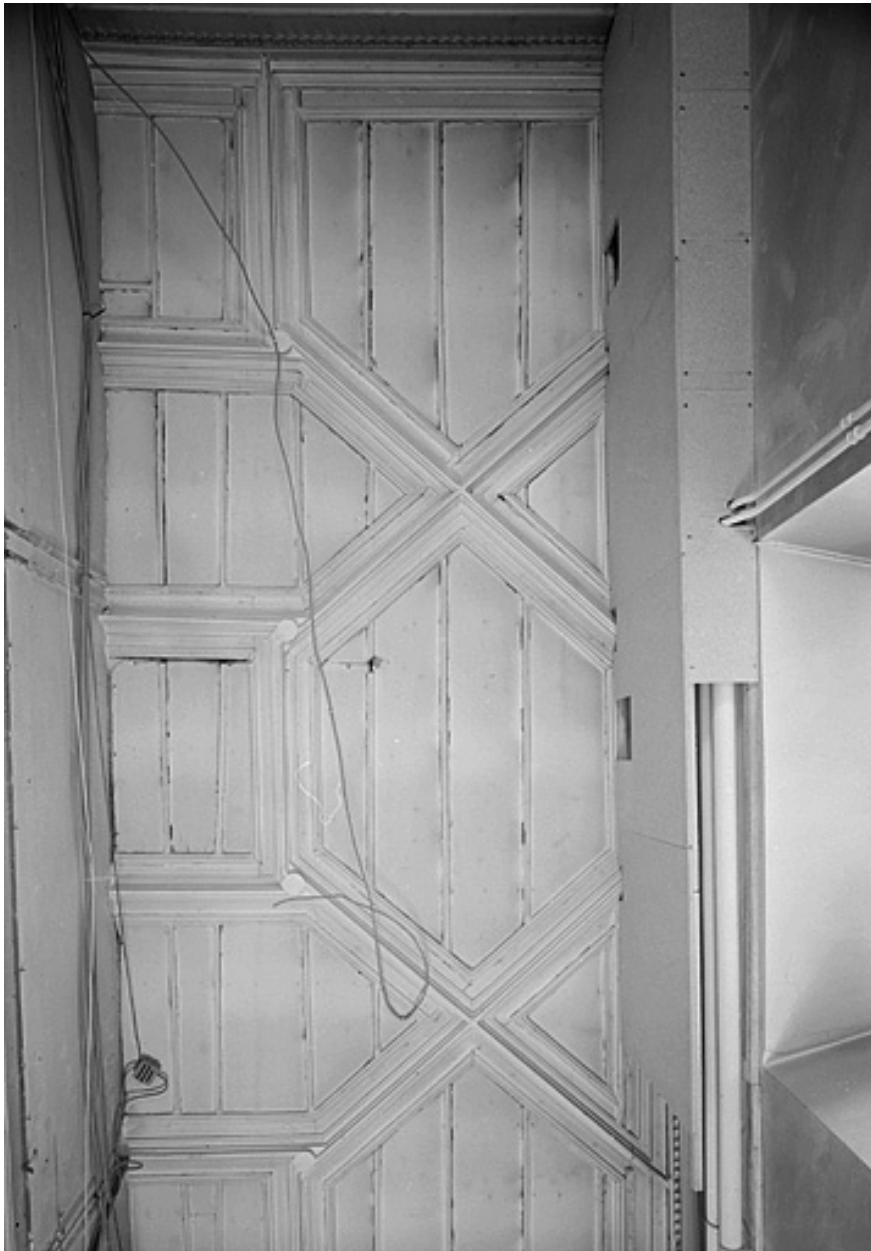
Plafond "à motifs complexes" [au premier étage du corps de bâtiment principal].
