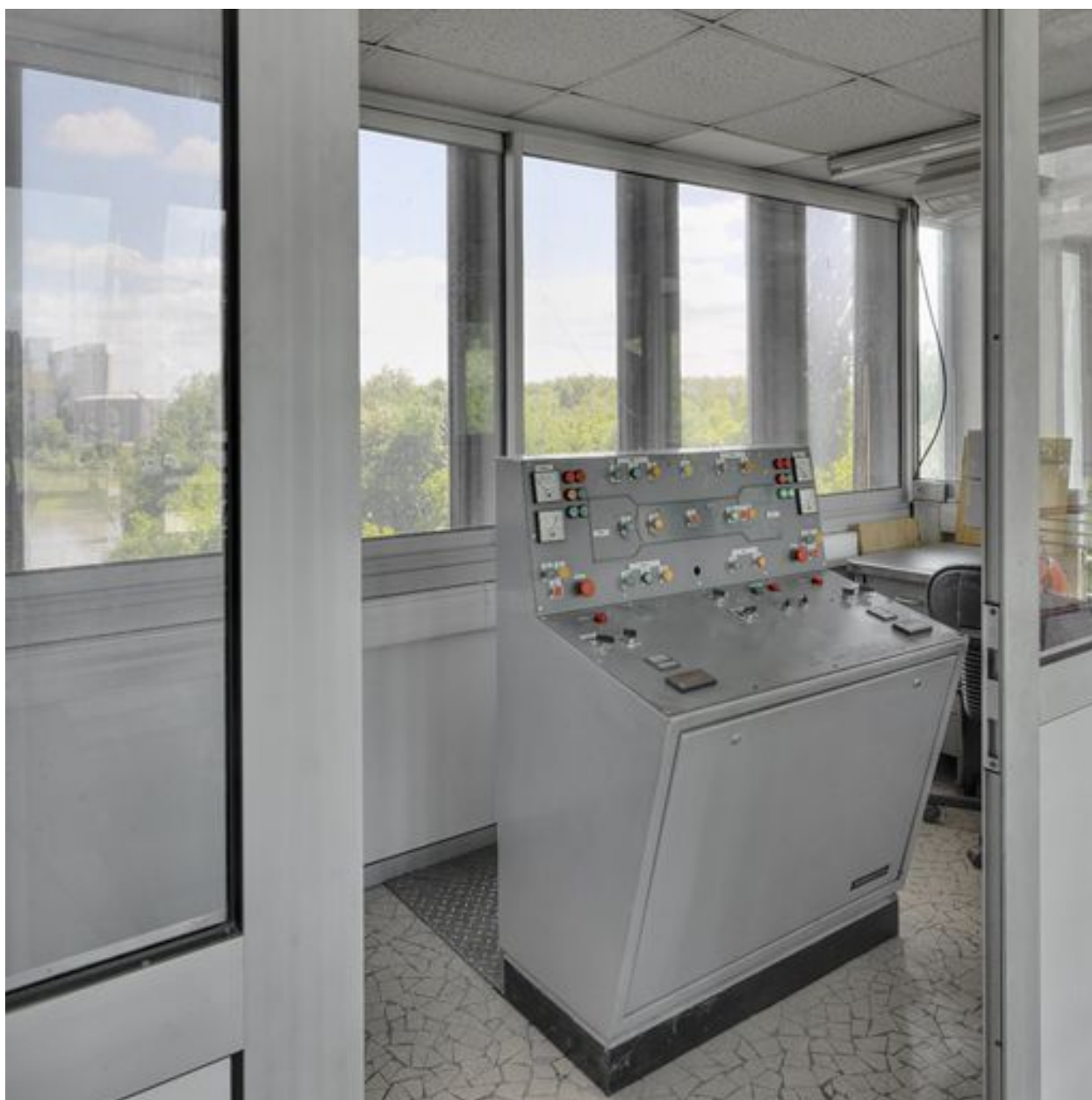
Vue intérieure de l'ancien poste de commande.
