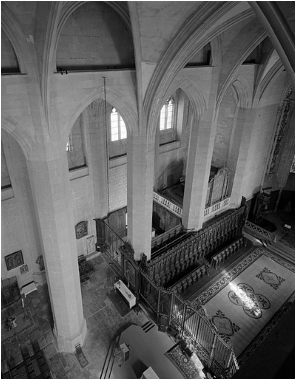
Elévation nord des travées orientales de la nef depuis la coursière haute.
