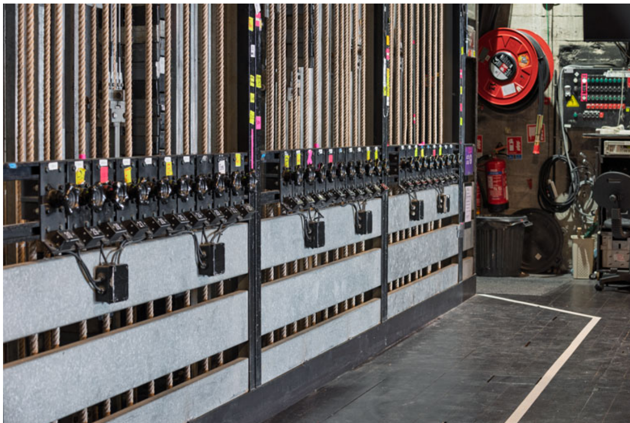
Maison de la culture, grande salle : commandes des perches, au bas de la cheminée de contrepoids.
