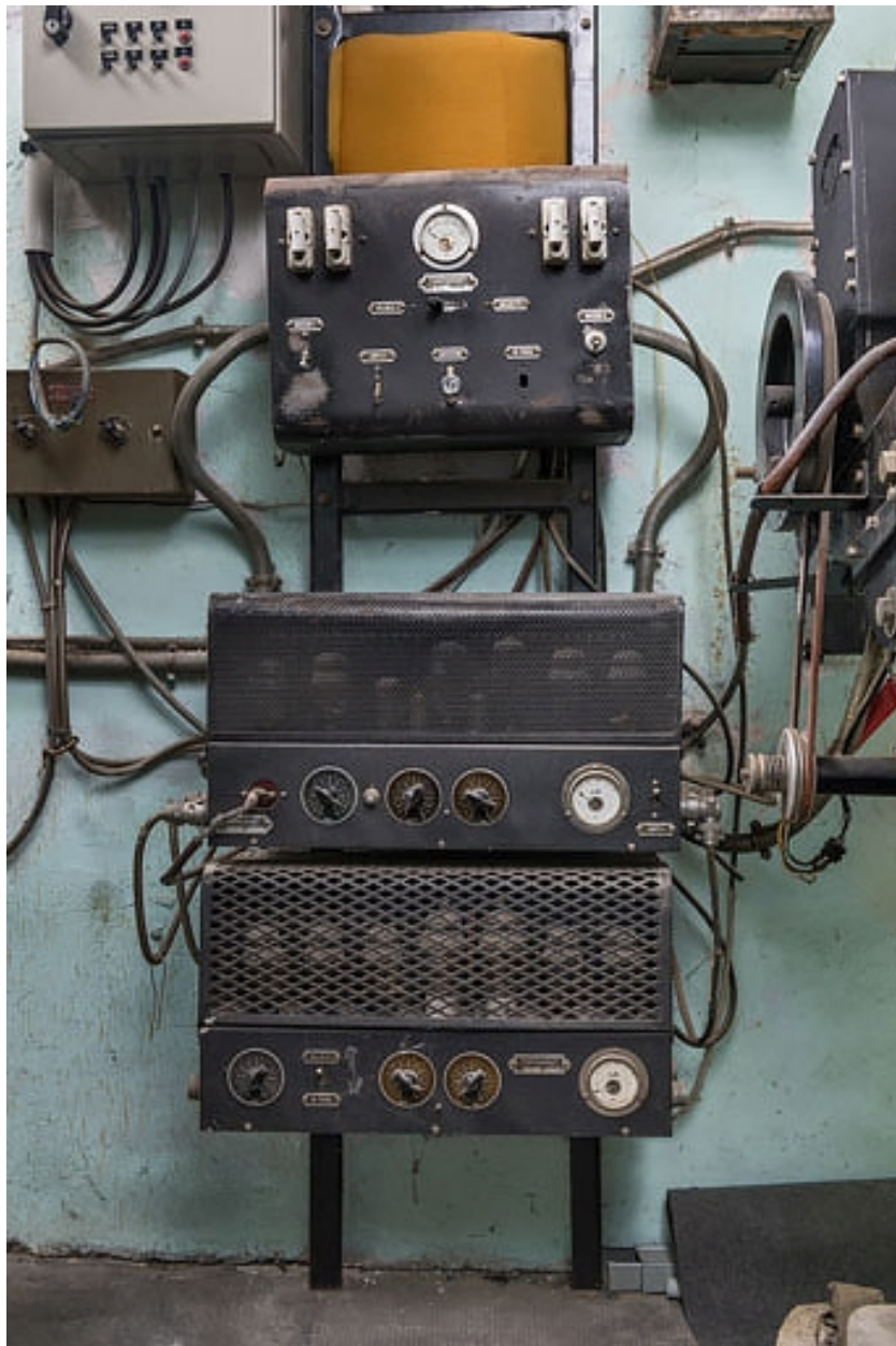
Installation de sonorisation : amplificateurs.
