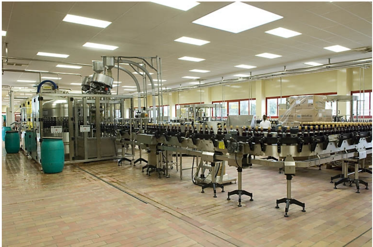
Atelier de conditionnement. Salle d'embouteillage. Vue d'ensemble.
